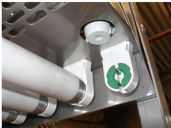
Figure 8 : carénage inox au-dessus des tubes fluorescents
