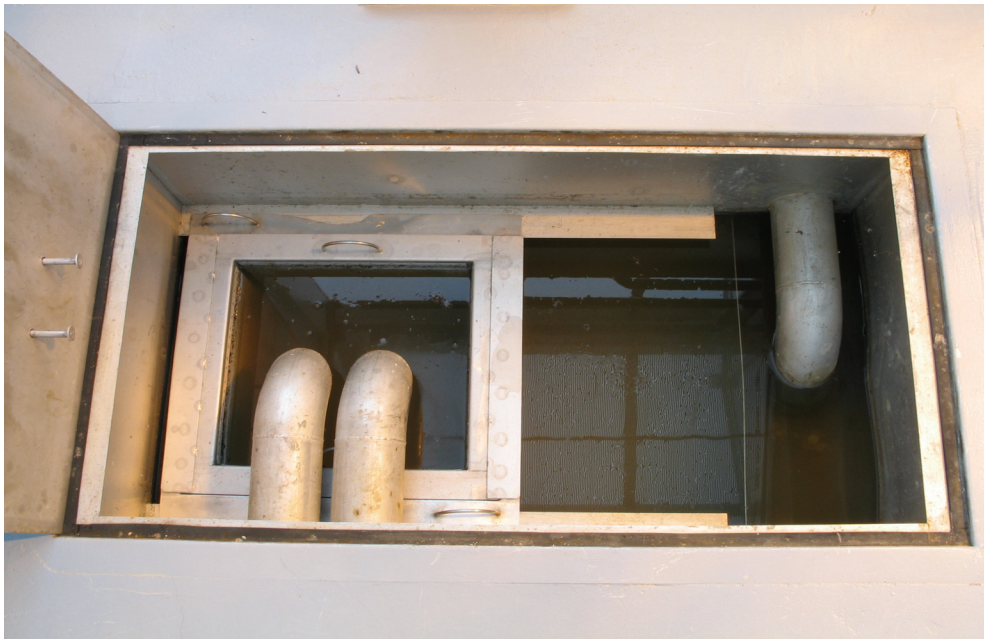
Filtre à particules solides installé dans notre serre S2
